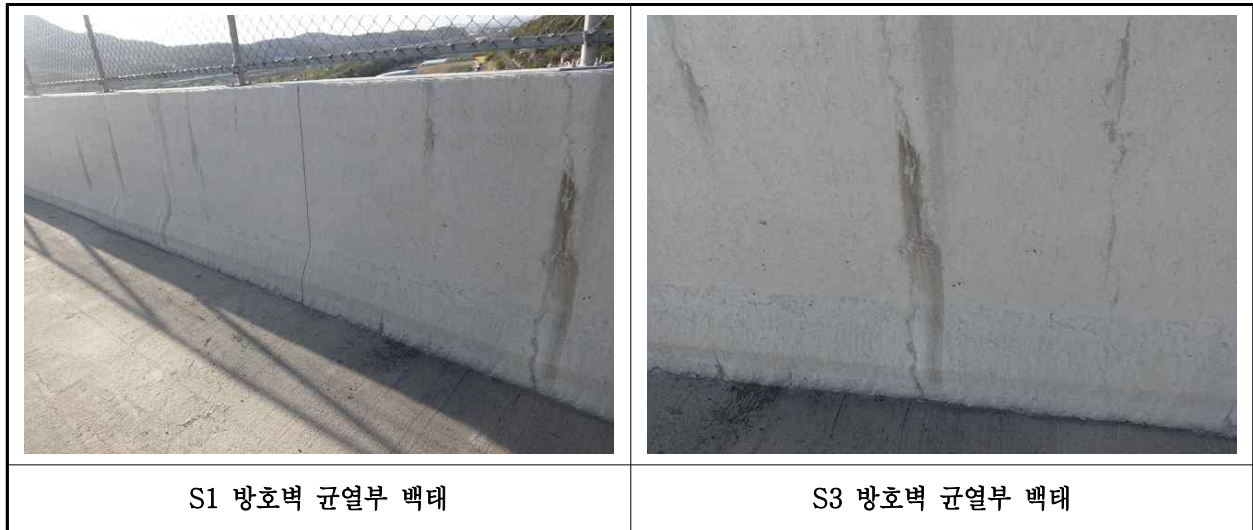
【사진 40.3.43】 방호벽 및 중앙분리대 손상현황
