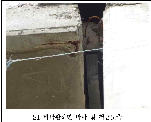
【사진 40.3.3】 바닥판하면 손상현황
