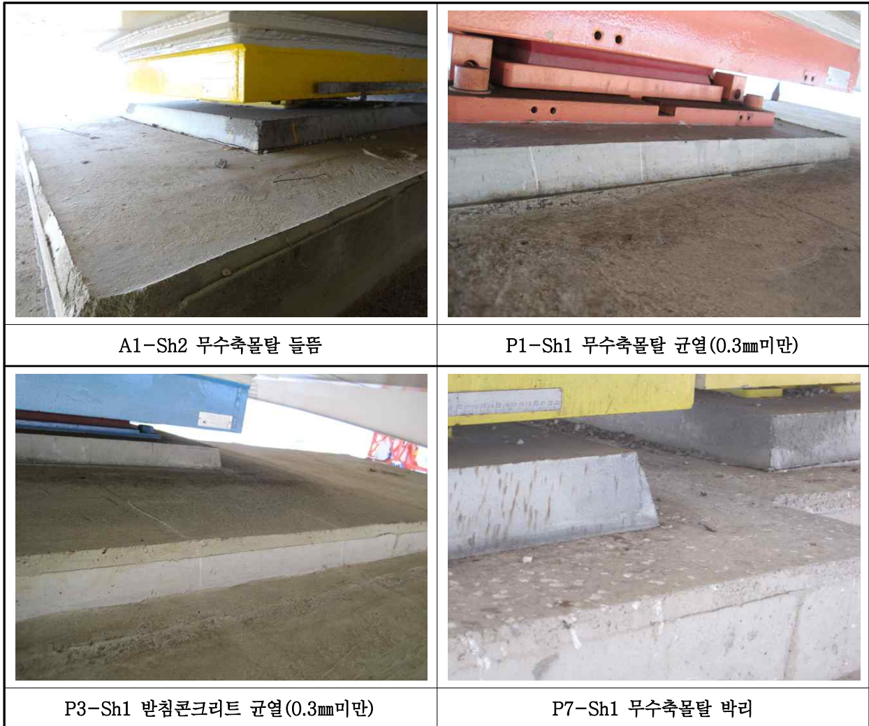
【사진 40.3.33】 교량받침 손상현황
